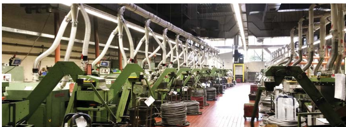
På Bilden: Lokalen efter att Absolent installerats
