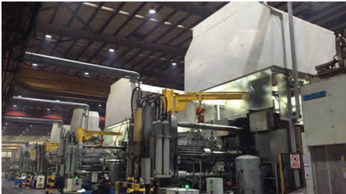
På Bilden: Central installation av A-Smoke80TF med huvar
